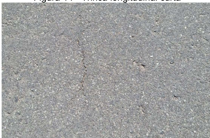
Figura 14 - Trinca longitudinal curta
