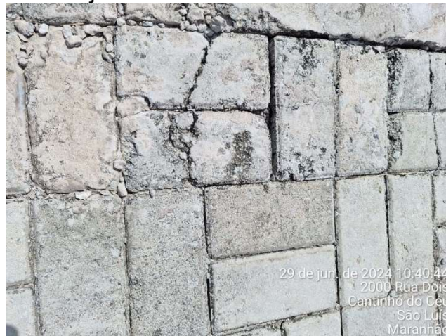
Figura 19 - Peças com trincas isoladas transversais curtas
