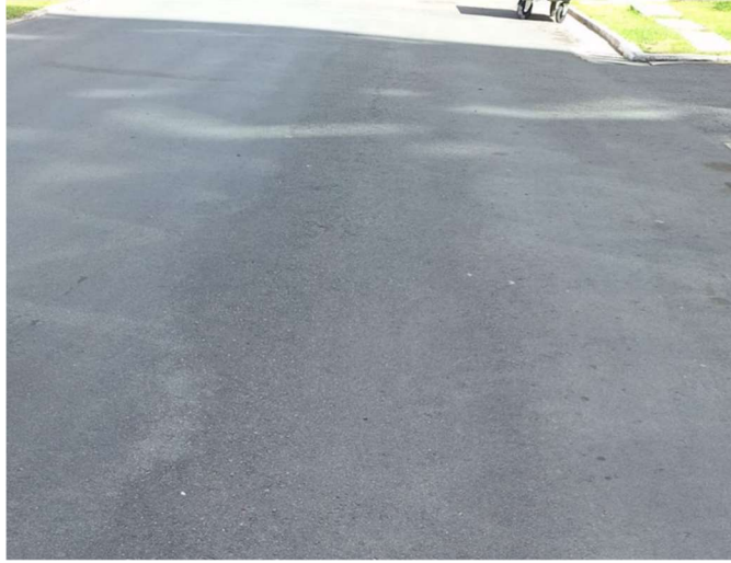
Figura 18 - Afundamento de trilha de roda
