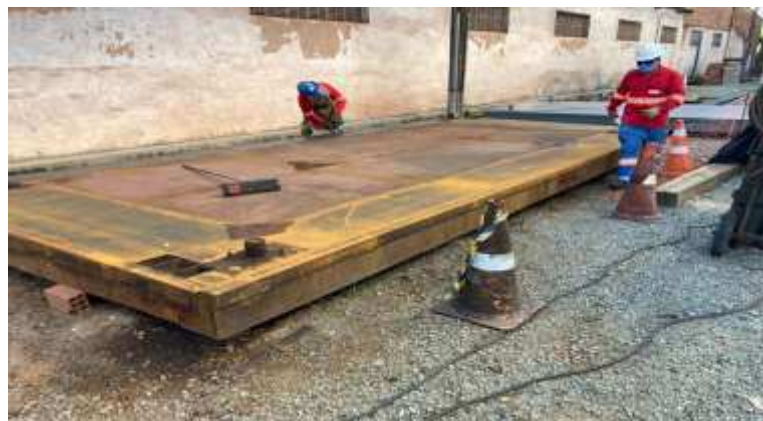
Figura 3.5 – Balança n° 1 apresentando corrosão na estrutura metálica e na pedra de concreto. Fonte: Autor (2021).
