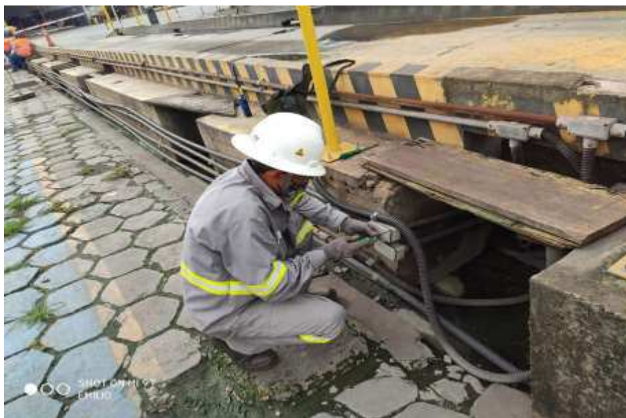
Figura 3.7 – Eletrodutos expostos na balança antes do processo de revisão. Fonte: Autor (2021)
