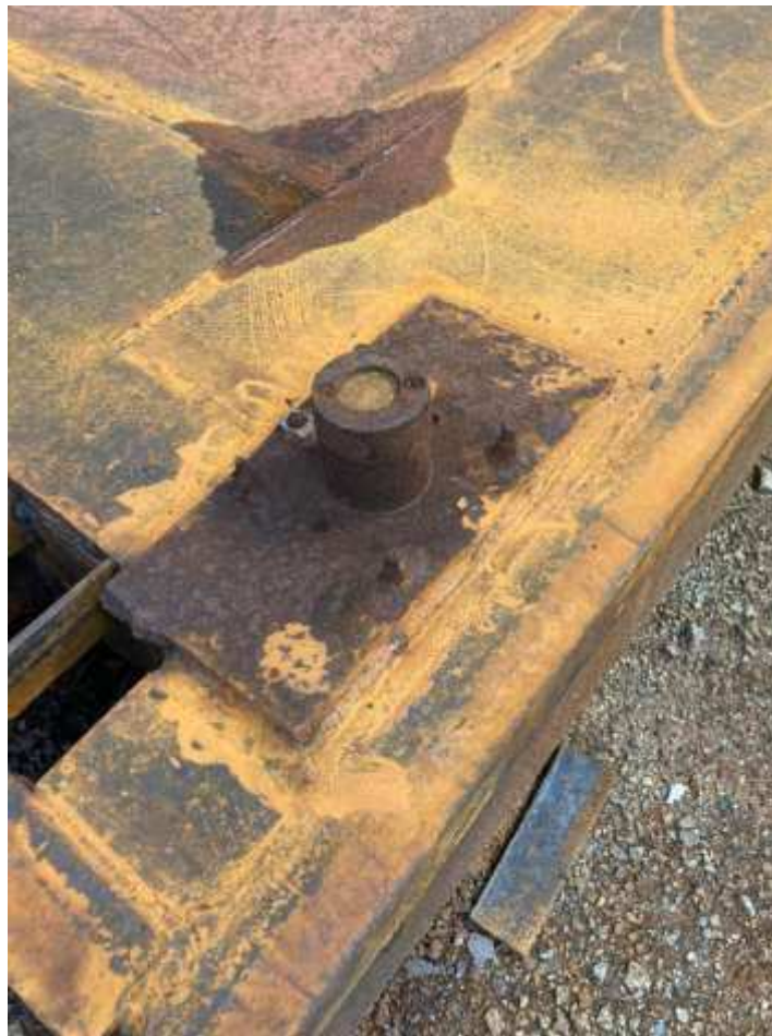
Figura 3.6 – Célula de carga com corrosão. Fonte: Autor (2021).
