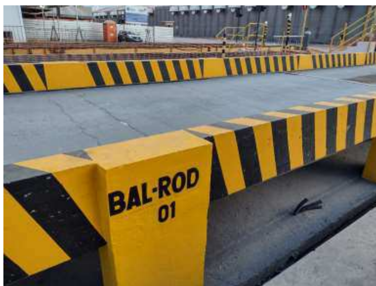
Figura 4.1 – Balança rodoviária após recuperação. Fonte: Autor (2021).
