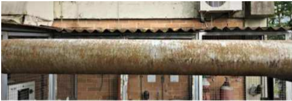
Figura 2.2: Corrosão em uma tubulação industrial exposta às condições climáticas (LATTMANN, 2020)
