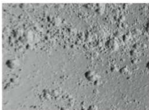
Figura 2.6: Corrosão Puntiforme (GENTIL, 2011)
