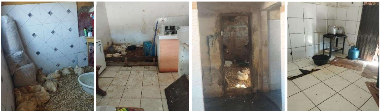
Figura 1. Condições dos pisos e paredes observados em alguns dos locais visitados.
