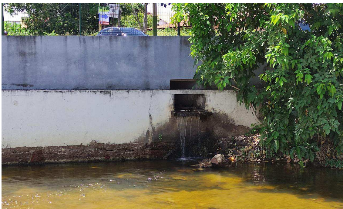
Figura 11 - Galeria de esgoto direto para a piscina
