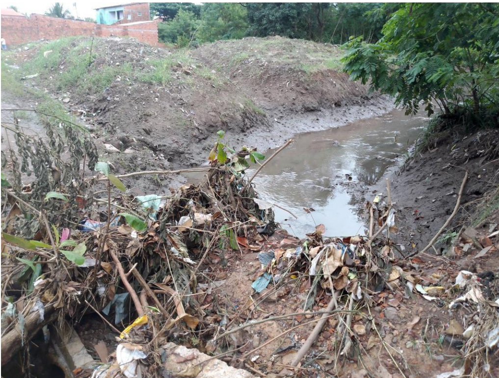
Foto 9: Sinais de transbordamento sobre a 2ª Tv. São Francisco.
