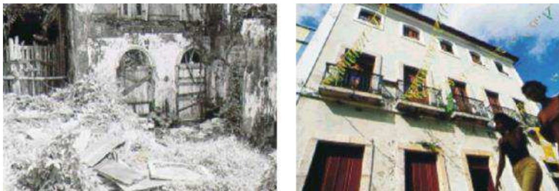
Figura 35 - Imóvel completamente arruinado passou a abrigar as famílias
