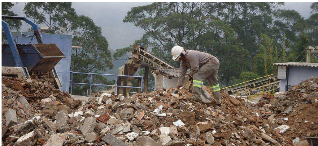
Figura 1: Acúmulo de resíduos da construção civil.
