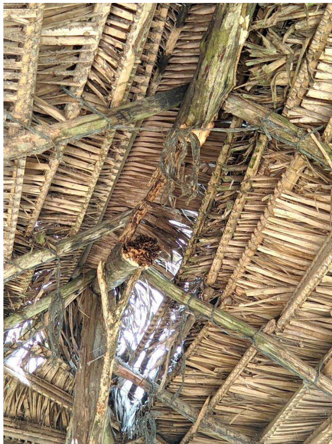
Figura 11 – Cumieira apodrecido devido a ação de cupim
