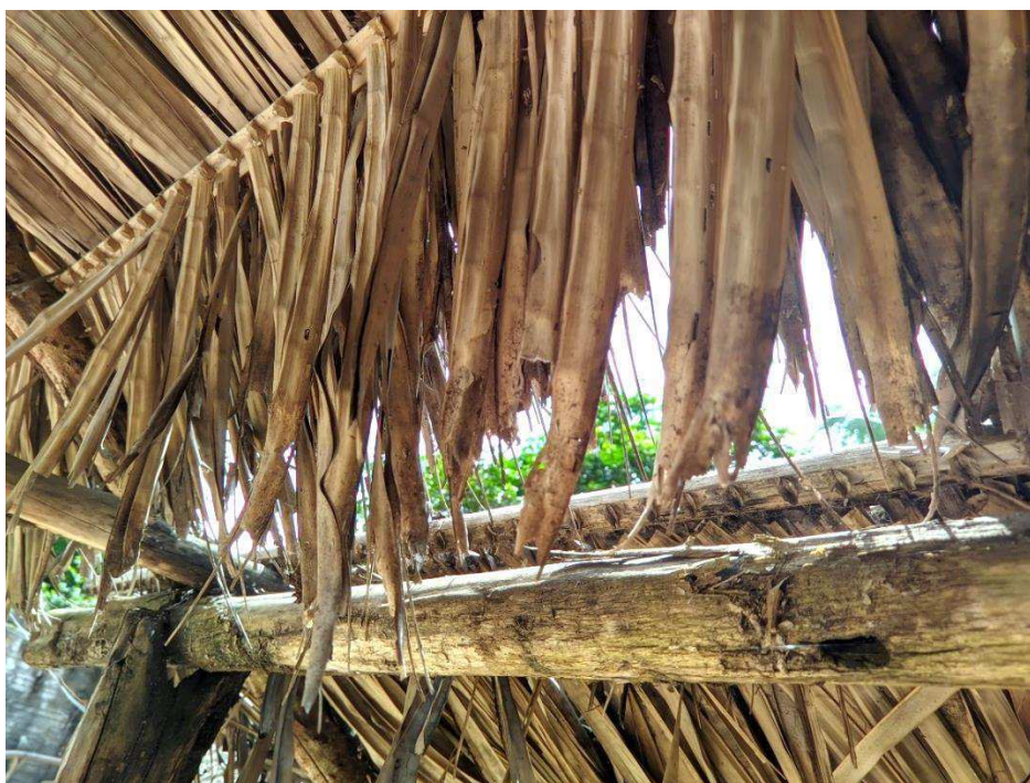
Figura 13 – Telhado de palha apodrecido
