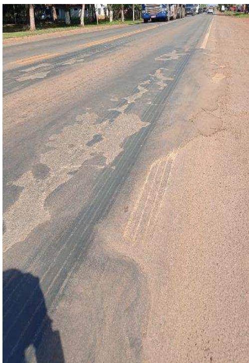
Figura 21 - Escorregamento do Revestimento Asfáltico (Km 181).
