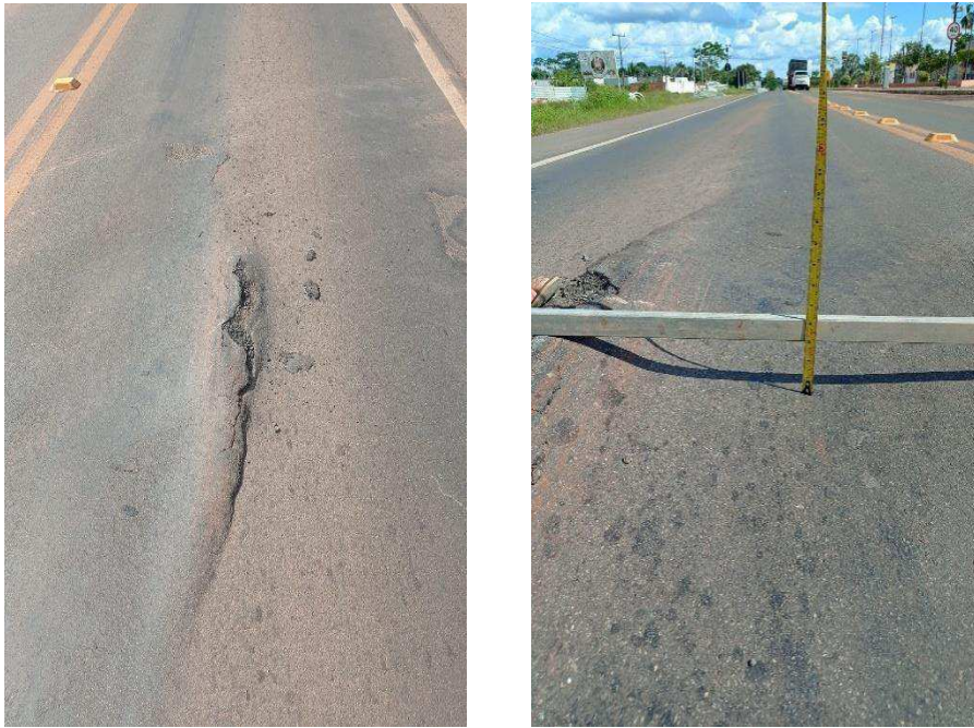
Figura 21- Escorregamento do Revestimento Asfáltico e Afundamento (Km 182).
