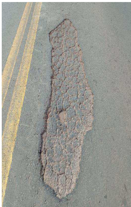
Figura 24 - Trinca couro de jacaré com erosão (Km 183,2).
