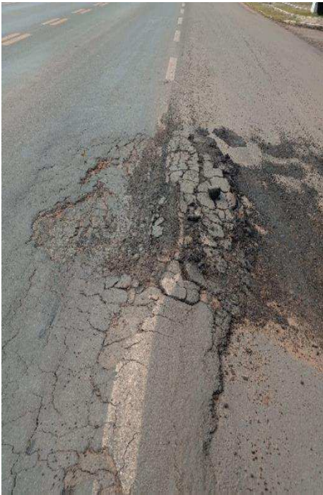
Figura 23- Afundamento por consolidação localizado (Km 182,8).
