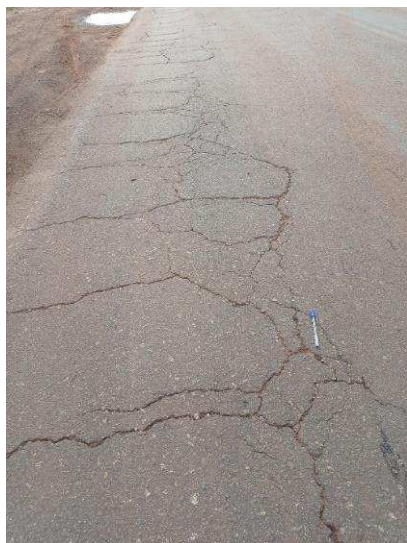
Figura 19 - Trinca interligada Transversal (Km 179,8)
