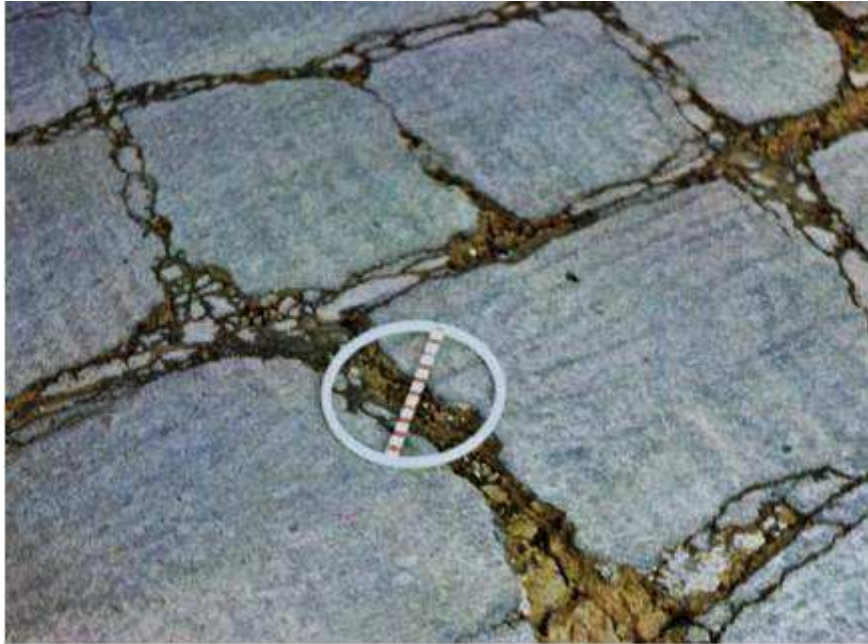
Figura 13 - Trinca interligada tipo Bloco
