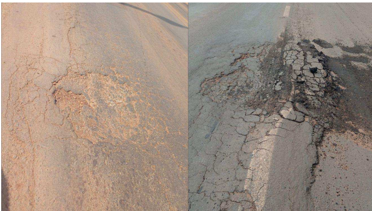
Figura 18 - Comparativo entre patologias KM 182,8
