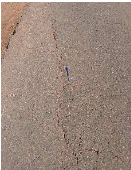
Figura 20 - Trinca isolada Longitudinal (Km 180).
