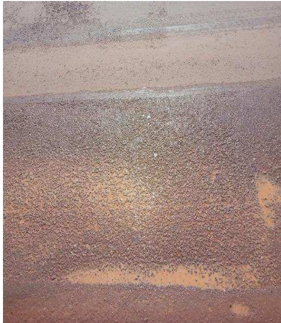
Figura 22 - Patologia Desgaste (Km 182,5).
