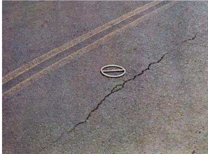
Figura 14 - Trinca Isolada Longitudinal
