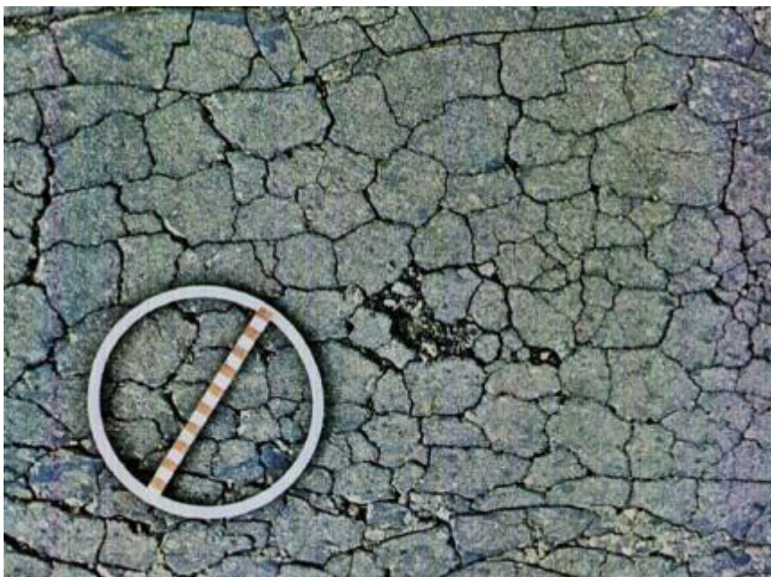
Figura 12 - Trinca interligada tipo couro de jacaré
