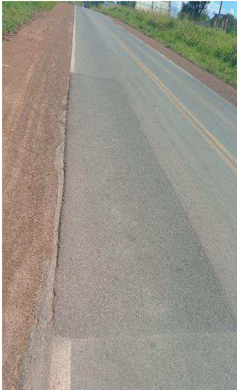
Figura 25- Patologia Remendo (Km 183,9)
