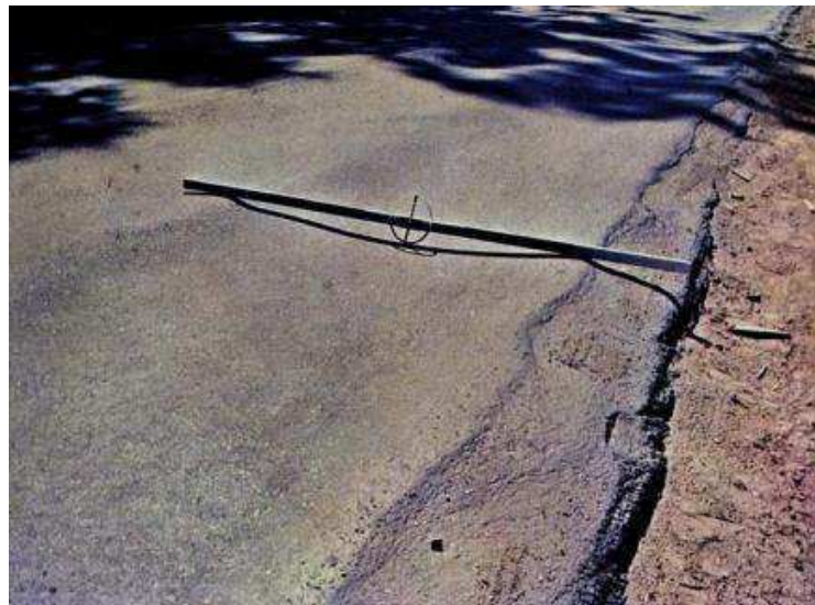
Figura 5 - Afundamento de trilha de roda
