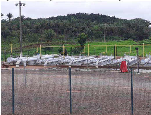
Figura 11 - Estação de Tratamento de gás natural em Santo Antônio dos Lopes.
