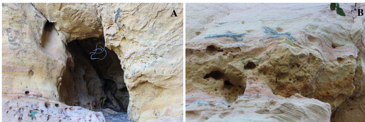
Figura 35 - Toca da Picada A: Paredes com marcas de Infiltração B
