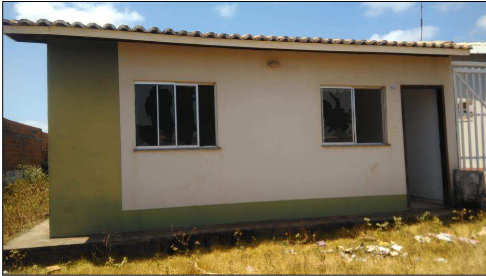
Figura 19 - Residência abandonada e depredada no RCV I
