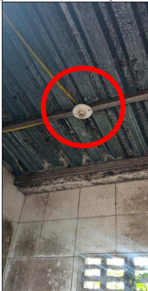
Figura 14: Local de armazenamento externo dos resíduos infectantes e perfurocortantes, sem iluminação.
