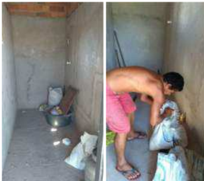
Figura 83 – Banheiros utilizados como depósitos
