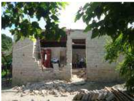
Figura 73 – Casa de adobe de José Raimundo, semi-demolidada
