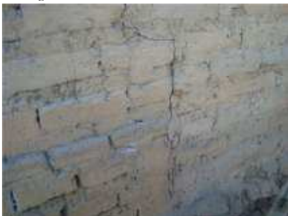
Figura 30 – Parede de adobe com fissuras
