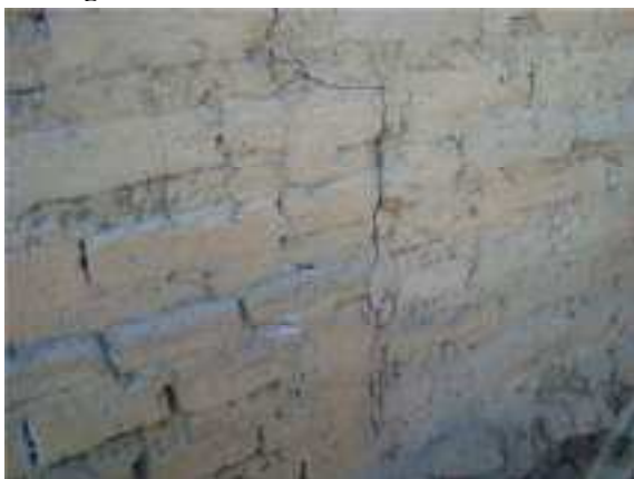
Figura 30 – Parede de adobe com fissuras
