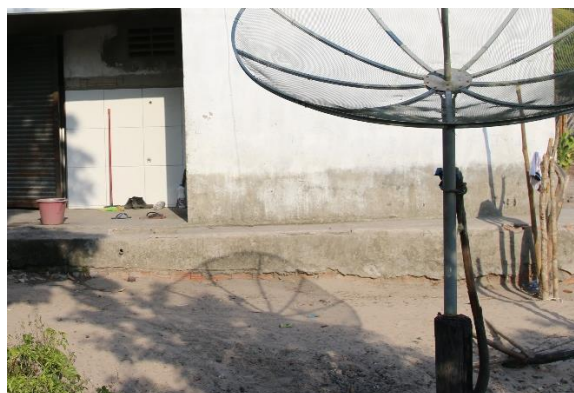
Figura 72 – Calçada apresentando sinais de má execução
