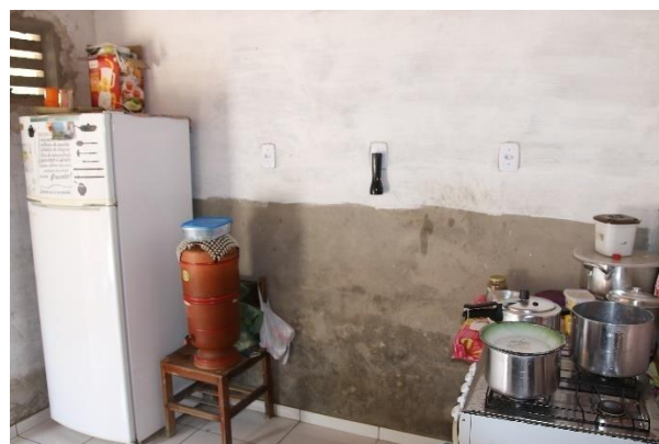
Figura 70– Cozinha sem instalações hidráulicas e louças
