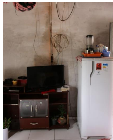
Figura 68– Instalação elétrica improvisada
