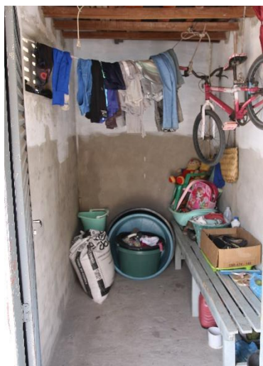
Figura 69– Banheiro sem revestimento e louças
