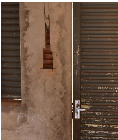
Figura 67– Instalação elétrica ausente
