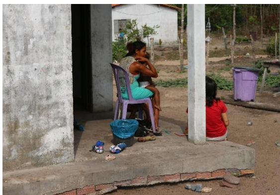
Figura 71 – Detalhe da calçada em estado de deterioração
