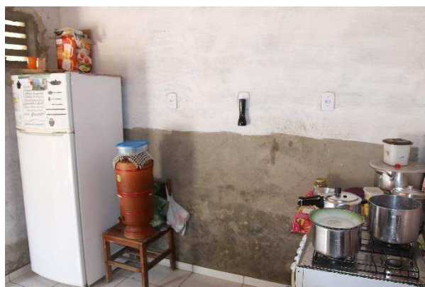
Figura 70– Cozinha sem instalações hidráulicas e louças
