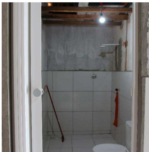
Figura 102 – Banheiro da casa de M.N
