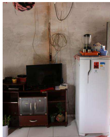
Figura 68– Instalação elétrica improvisada
