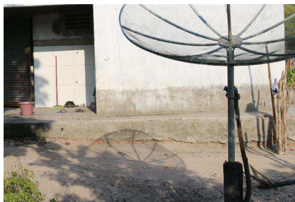
Figura 72 – Calçada apresentando sinais de má execução
