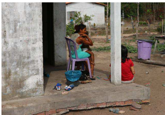
Figura 71 – Detalhe da calçada em estado de deterioração
