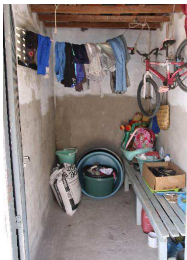
Figura 69– Banheiro sem revestimento e louças
