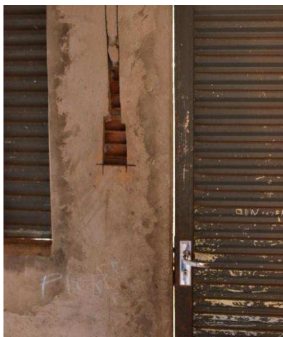
Figura 67– Instalação elétrica ausente
