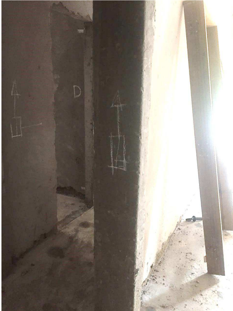
Figura 34 - Momento da verificação da interferência do pilar e do interruptor na obra
