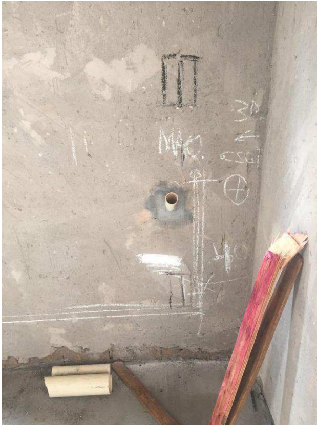
Figura 40 - Incompatibilidade de Projeto Hidráulico x Projeto Elétrico
