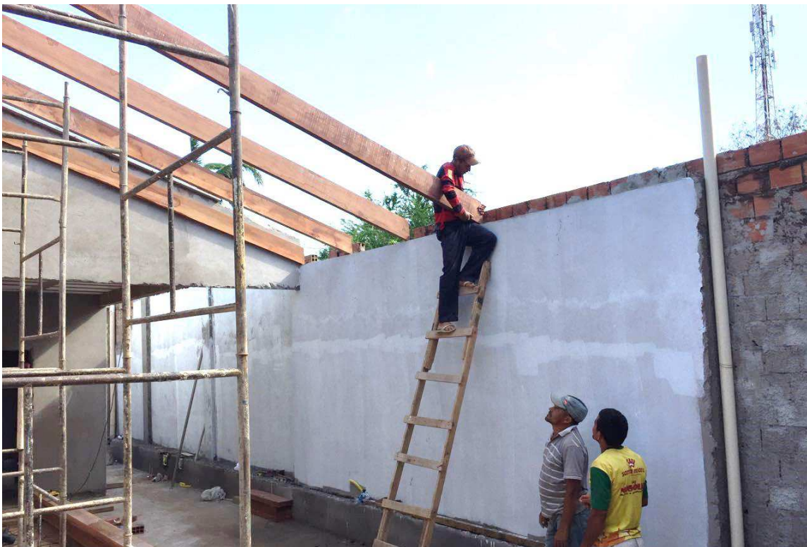
Figura 42 - Situação do conflito gerado na obra
