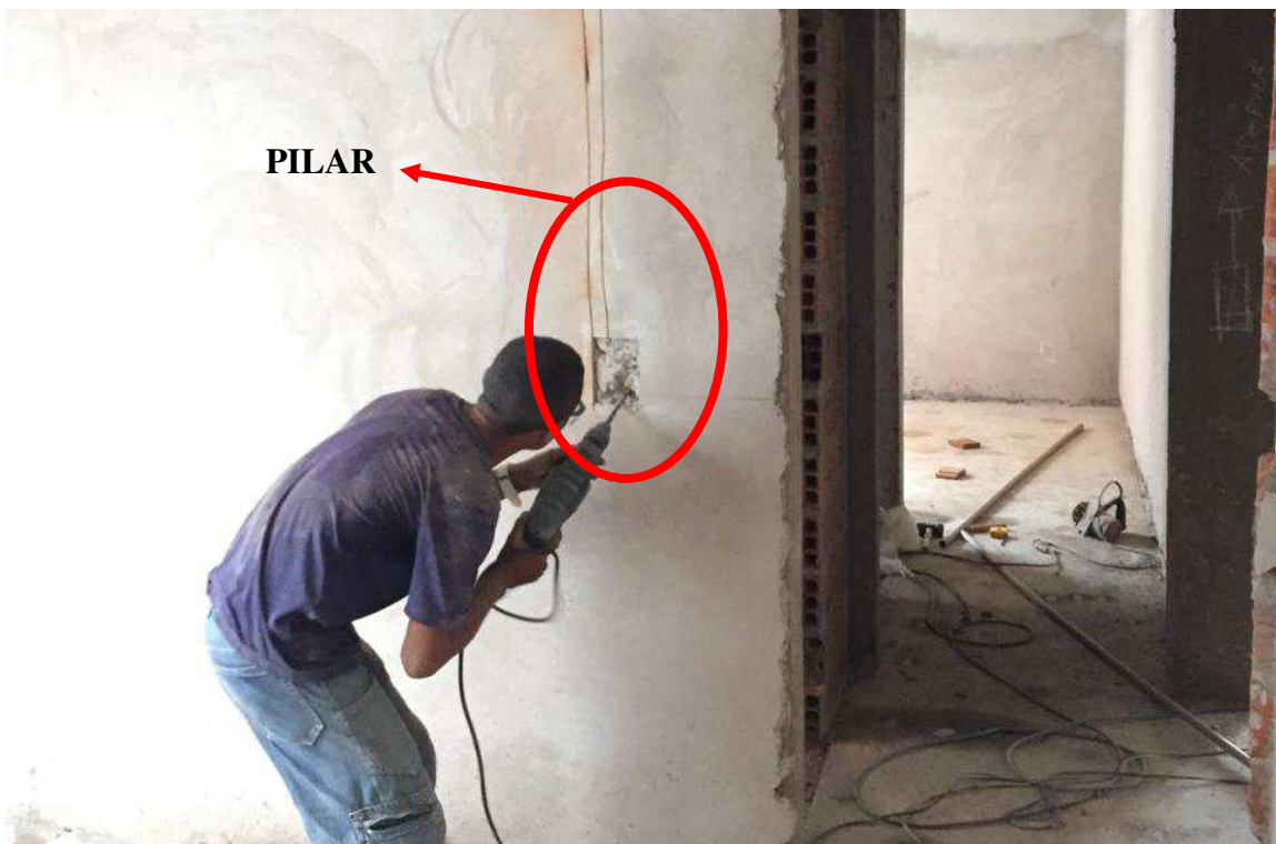
Figura 36 - Quebra do pilar
