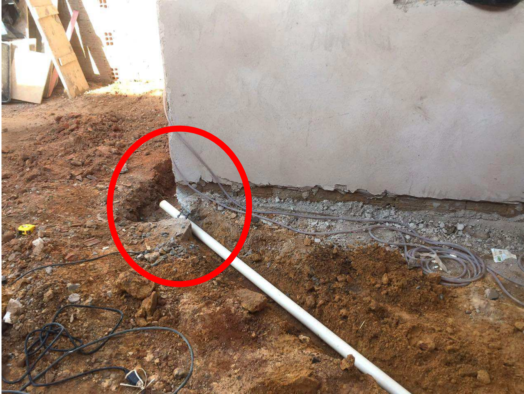
Figura 31 - Interferência entre viga baldrame x tubulação sanitária detectada em obra
