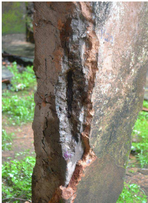
Fotografia 17 – Estrutura de concreto totalmente carbonatada
