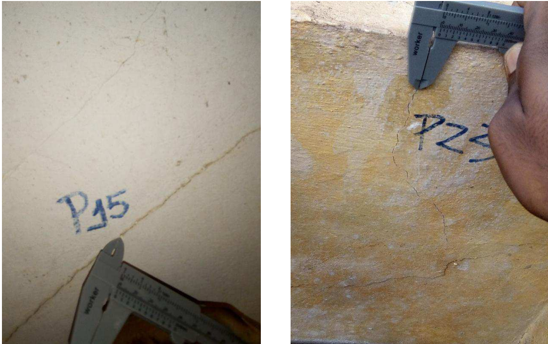
Fotografia 11 – Fissuras de 0,50 mm de abertura
