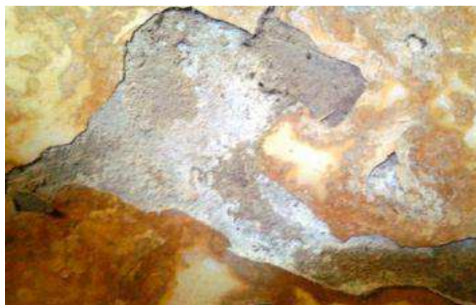
Fotografia 4 – Argamassa em estado de desagregação
