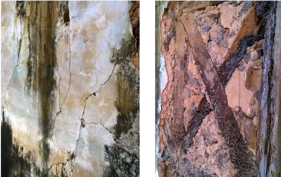
Fotografia 22 – Fissuras e trincas por conta do apodrecimento da madeira
