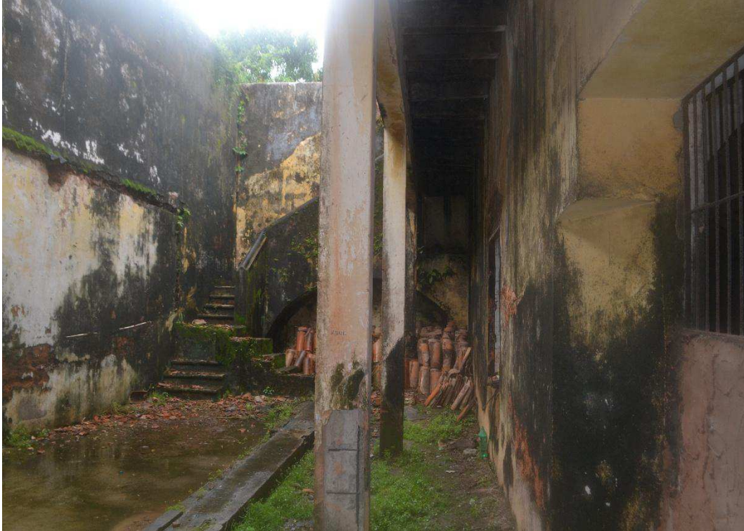
Fotografia 14 – Pilares e viga comprometidos pela carbonatação
