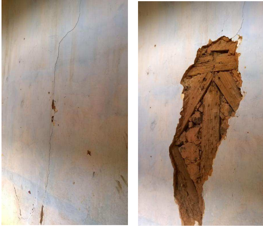
Fotografia 23 – Fissuração em alvenarias de pedra com travamento de madeira
