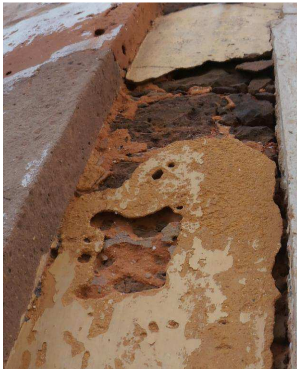
Fotografia 5 – Argamassa da fachada comprometida após ataque ácido
