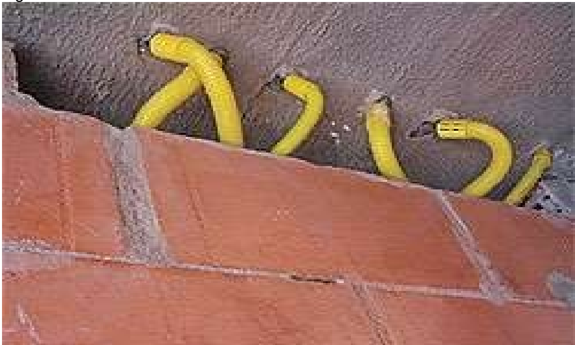
Figura 9 - Eletrodutos colocados no local errado
