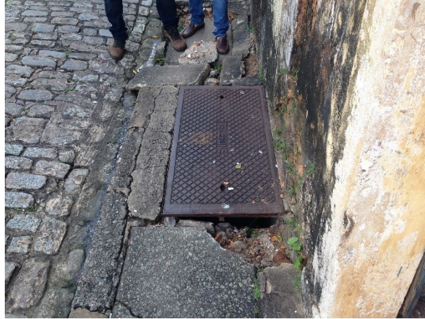
Figura 45 – Desgaste e caixa de inspeção em uma calçada do CHSL Fonte: O Autor (2018)
