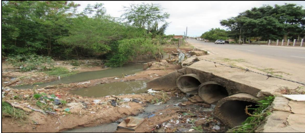
Figura 24 – Lançamento de esgoto no córrego Prata
