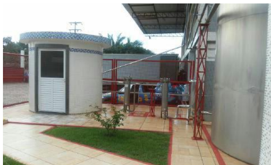
Figura 03- Casa do poço com sistema de filtros externos e reservatório, em uma indústria de água natural, em São José de Ribamar- MA, 2017.
