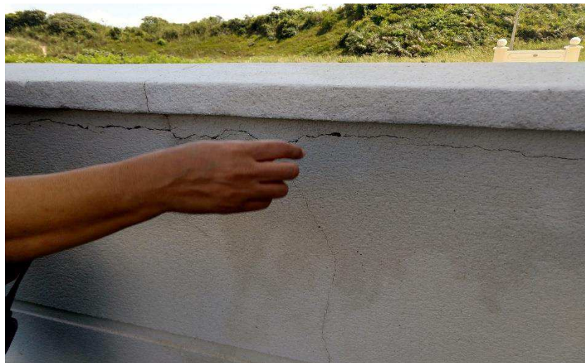
Figura 37 - Fissura em parede da área comum
