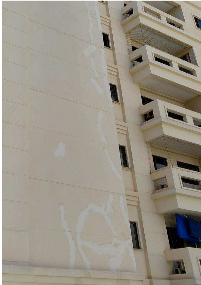
Figura 53 - Diferença de tonalidade entre o revestimento original e as restaurações pontuais
