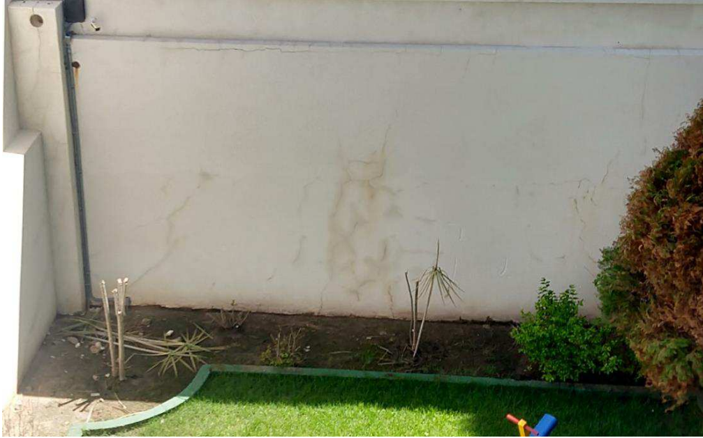
Figura 38 - Fissura em parede da área comum
