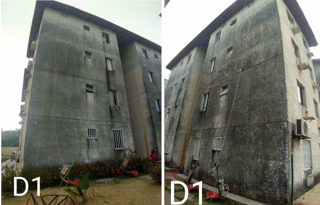
Figura 31 - Manchas causadas por intempéries
