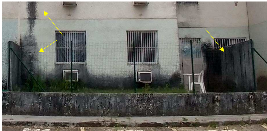
Figura 33 - Mancha causada por escoamento por falta de rufo metálico ou pingadeira em paredes divisórias
