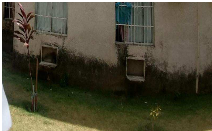
Figura 34 - Presença de fungo na base da torre devido a percolação
