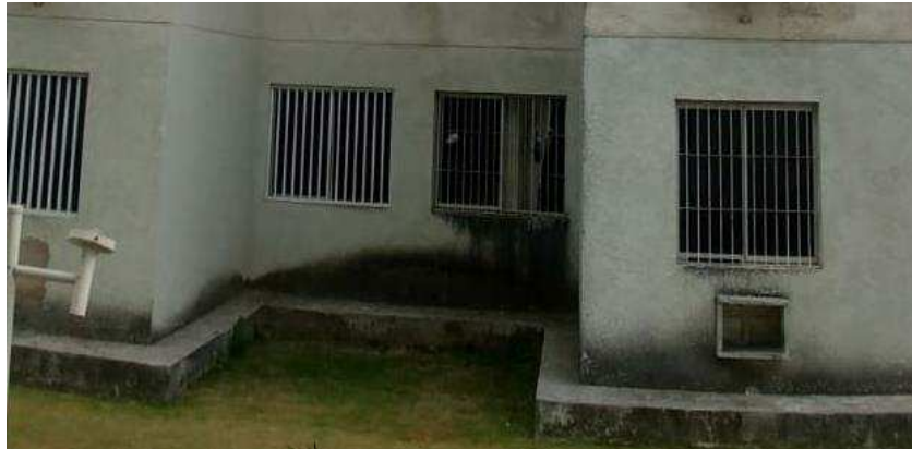
Figura 32 - Mancha causada por escoamento em peitoril
