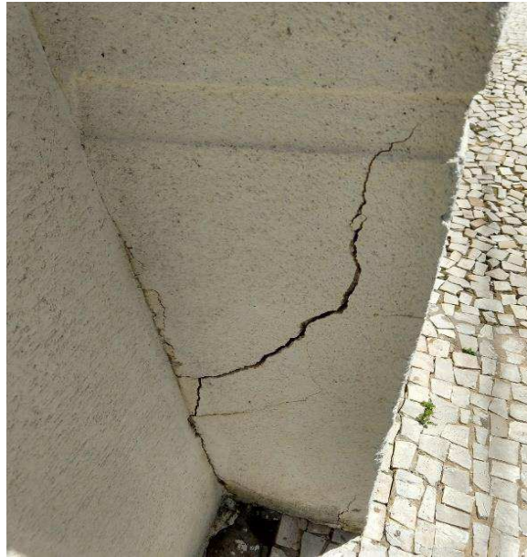
Figura 36 - Fissura no revestimento do muro do condomínio
