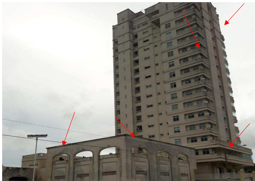
Figura 43- Manchas devido a intempéries no revestimento monocamada do empreendimento
