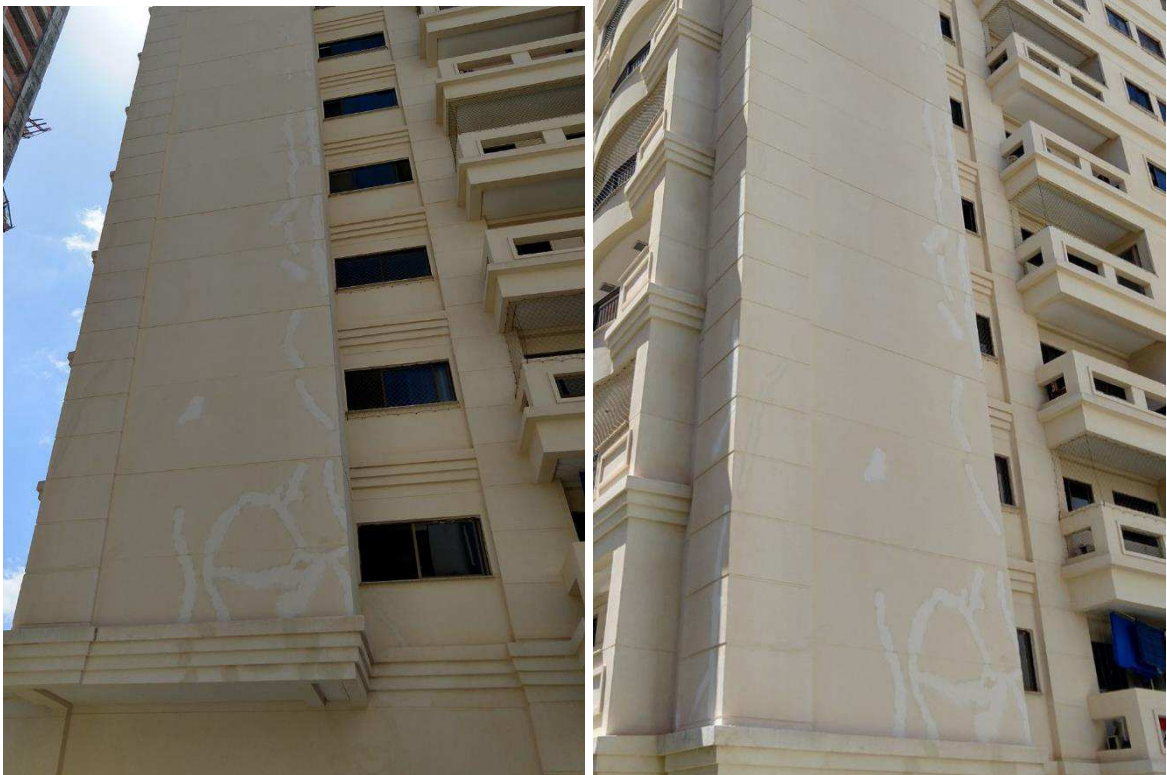
Figura 49 - Presença de fissuras (já tratadas) na fachada do Edifício Classic Home
