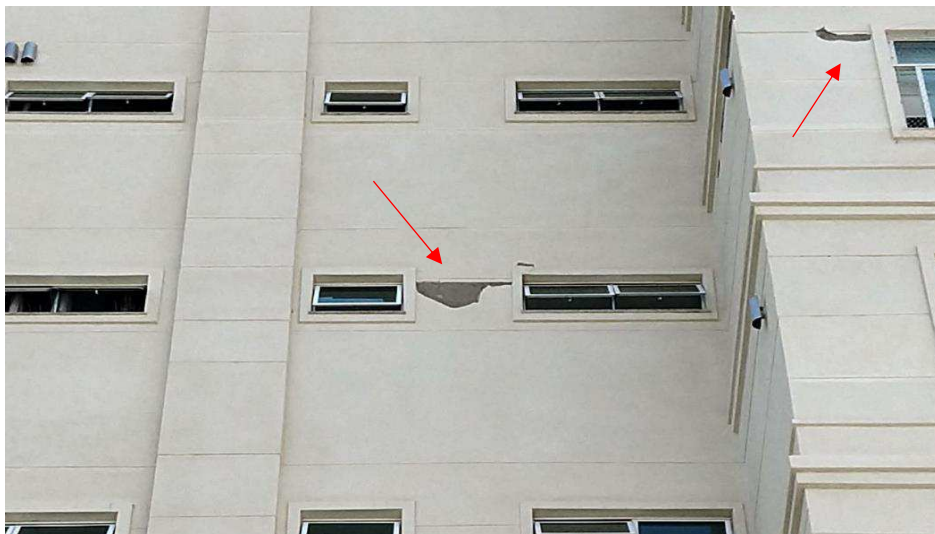
Figura 40 - Descolamento em placas no revestimento da torre
