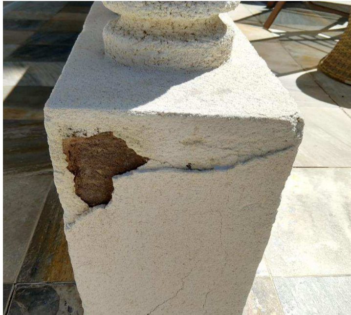
Figura 41 - Descolamento em detalhes da área comum
