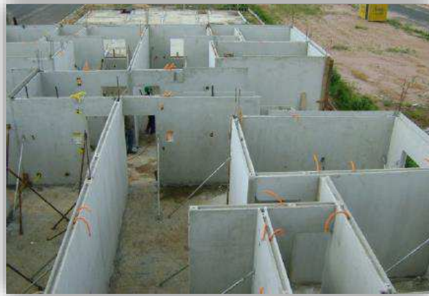
Figura 28 - Vista geral de obra do Condomínio Monterrey (Rio Claro/SP) em parede dupla
