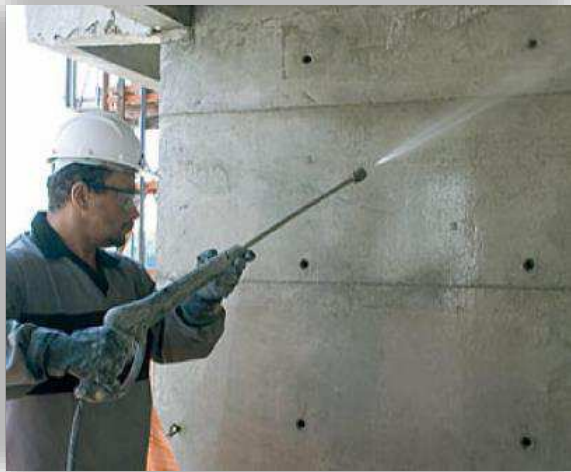
a) Lavagem da superfície da estrutura para realização da amarração da alvenaria;
