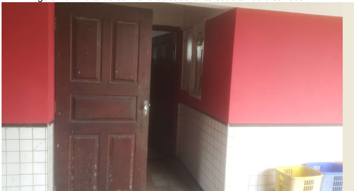
Figura 19 - Porta do banheiro de cadeirante estreitando o corredor
