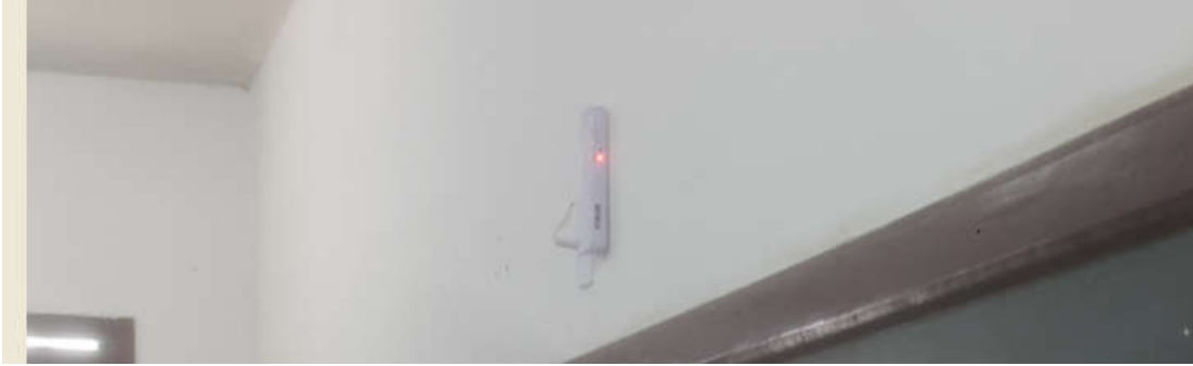
Figura 20 - Bloco autônomo bivolt de bateria recarregável (imagem de umas das salas de aulas)
