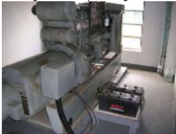
Figura 10 - Grupo moto gerador
