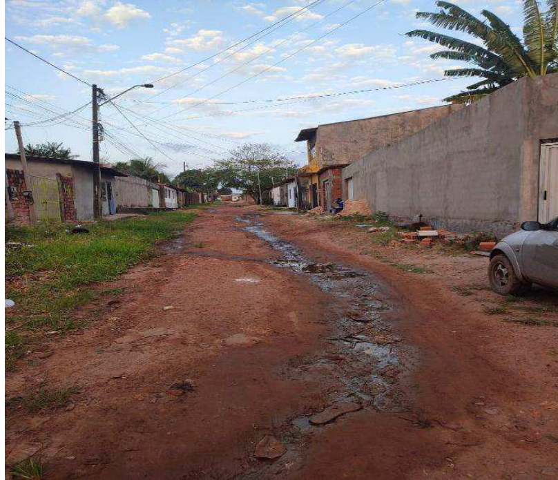
Figura 14 – Rua sem pavimentação
