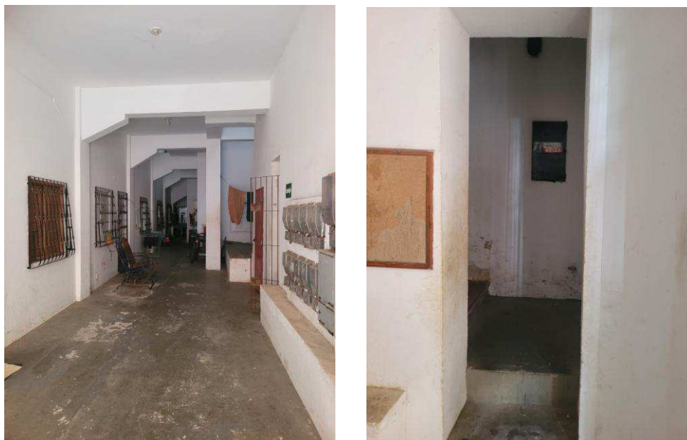
Figura 26 – Áreas de circulação do térreo e acesso à escada, representando a falta de reparos na pintura das paredes.
