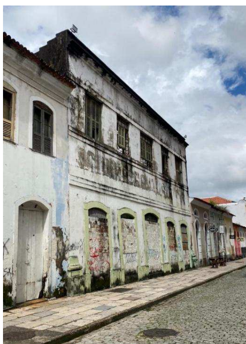
Figura 04 – Imóvel em estado de arruinamento localizado na Rua Portugal, uma das mais movimentadas do Centro Histórico de São Luís.
