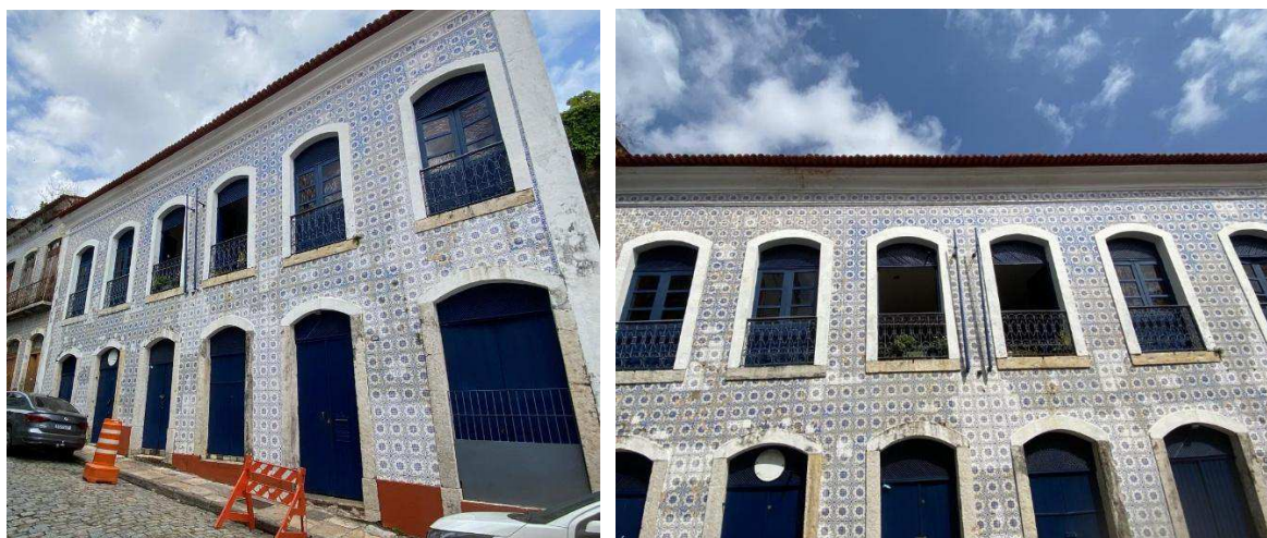
Figura 29 – Fachada e seus detalhes, destacando a aparência disforme dos azulejos. Edifício Rua da Estrela, nº 350.
