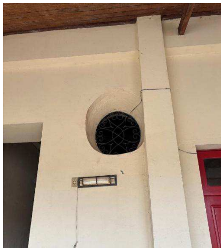
Figura 34 – Exemplo de abertura encontrada nos apartamentos laterais do Solar Afonso Pena, que não promovem uma ventilação robusta e nem iluminação suficiente quando posicionada na parede lateral limítrofe do lote (os fundos das unidades).
