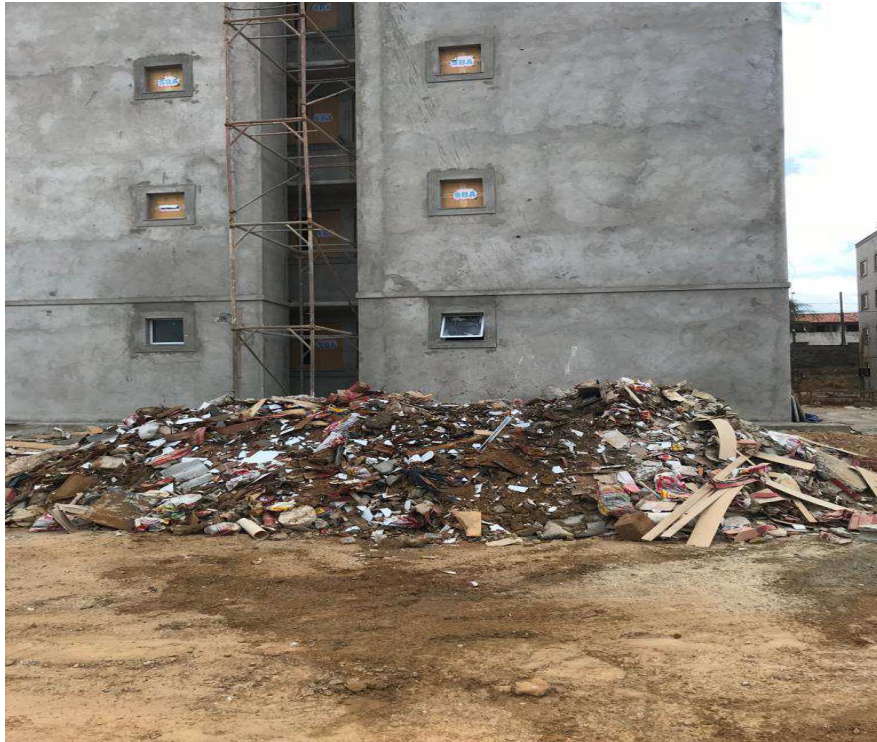
Figura 22 - Amontoado de resíduos no canteiro.
