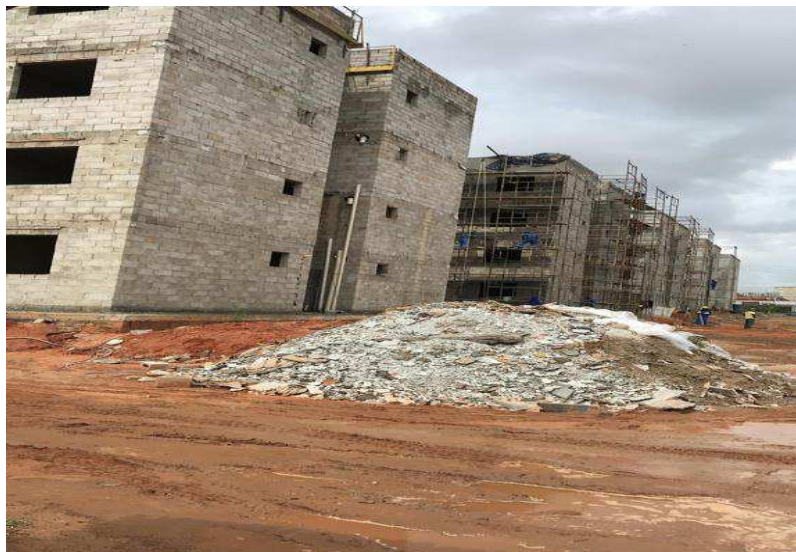
Figura 21 - Amontoados de resíduos no canteiro.
