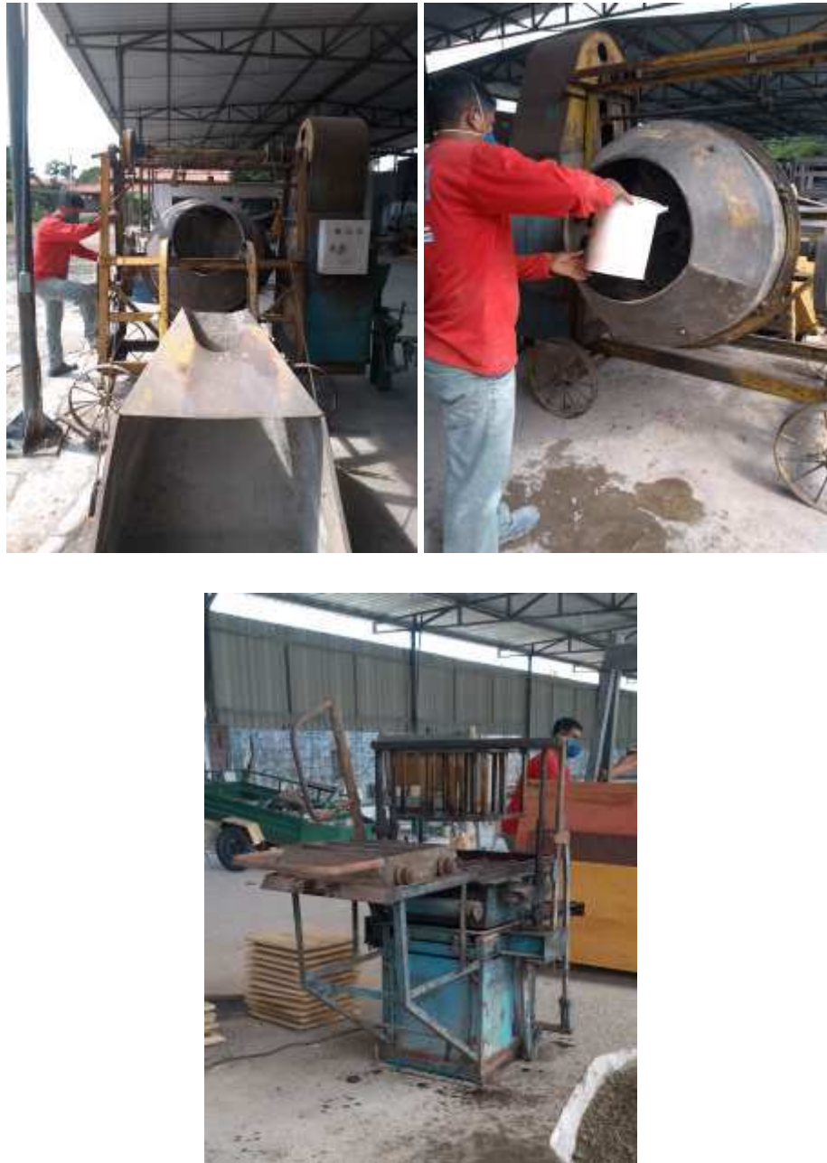
Figura 40 - Fabricação de blocos de concreto. (a) Posicionamento dos materiais na betoneira, (b) Dosagem da água, (c) Vibro-prensa manual utilizada.
