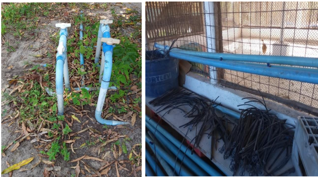
Fotografia 12 – Mosaico tubulação e material para irrigação área d o Agricultor 1
