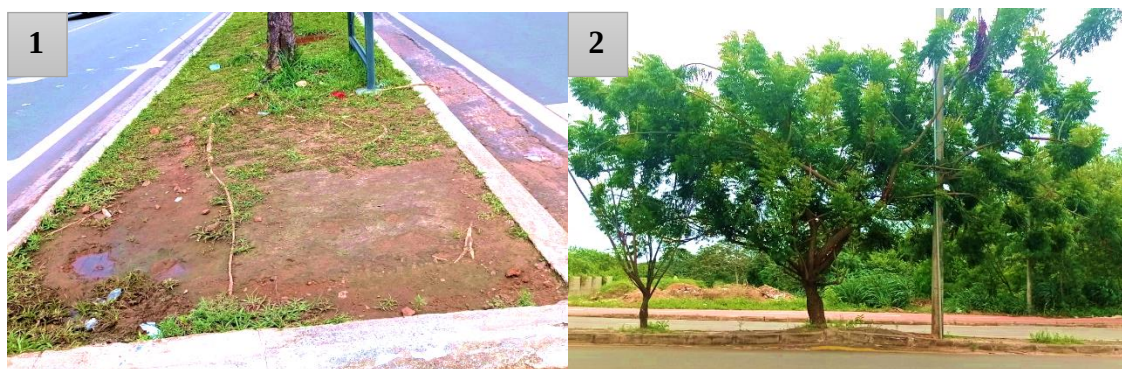
Figura 11 – Raízes expostas no canteiro central (1) no município de São Luís, (2) no município de São José de Ribamar – MA.
