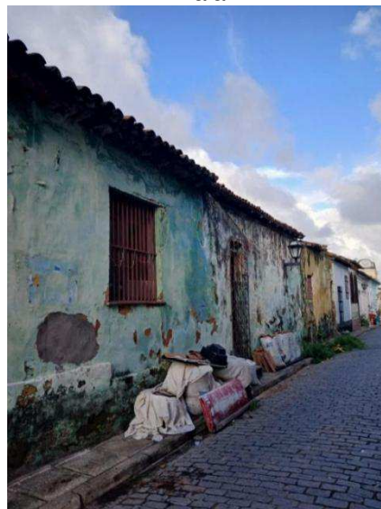
Imagem 52: Habitações precárias na Rua Jacinto Maia
