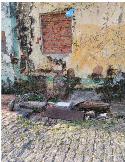
Imagem 51: Calçamento deteriorado na Rua Jacinto Maia
