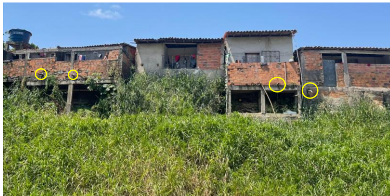
Figura 10: Na imagem é possível observar a presença de tubulações que saem diretamente das residências e é despejada no rio sem o tratamento adequado.
