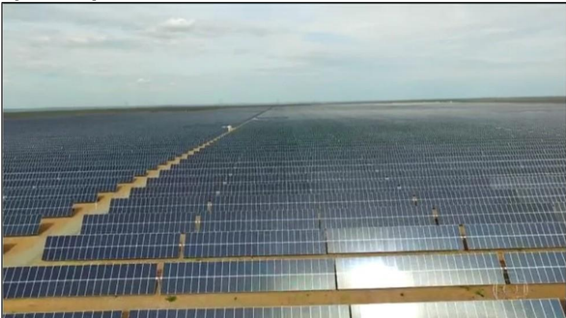
Figura 9 - Parque Solar Nova Olinda.
