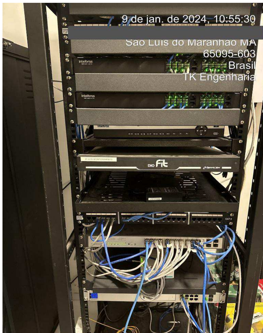
Figura 7 – Rack de telecomunicações.
