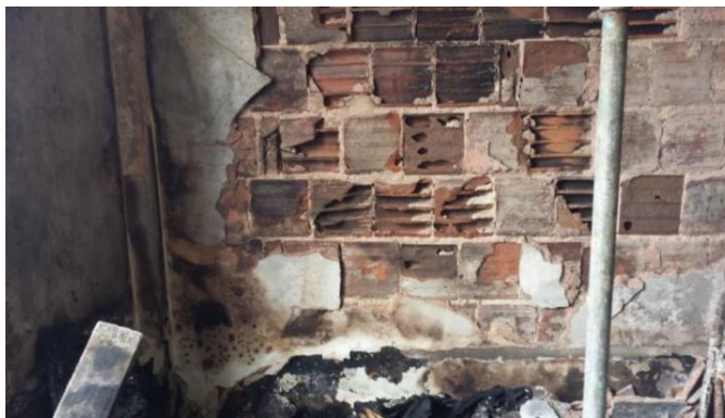
Figura 10 - Parede externa com os danos em sua superfície
