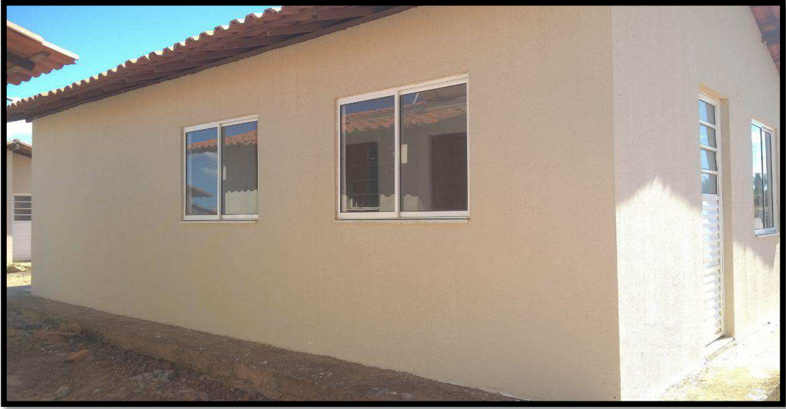
Fig. 25 – Vista lateral da UH com seladora
