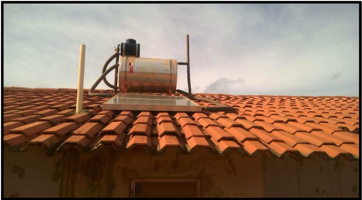
Fig. 22 – Aquecedor solar para chuveiro
