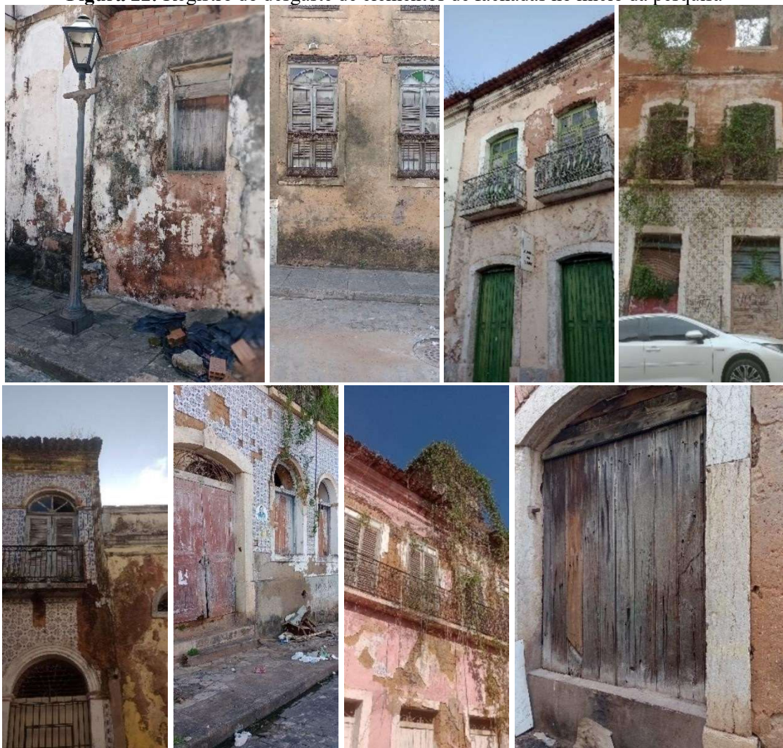
Figura 22: Registro do desgaste de elementos de fachadas no início da pesquisa
