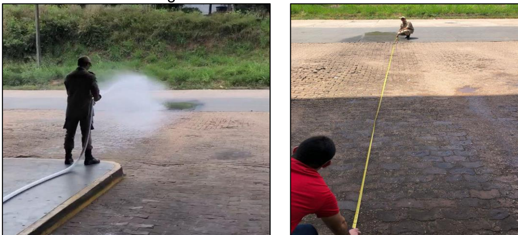
Figura 28 – Teste de Hidrante
