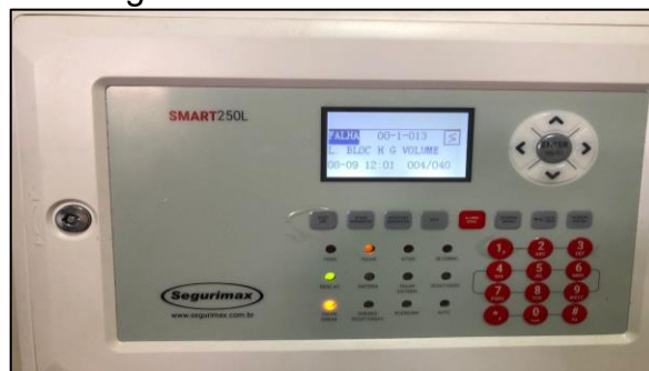
Figura 20 – Central de Alarme
