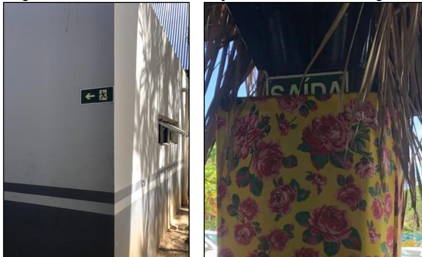
Figura 17 – Placas de Sinalização de Saída de Emergência
