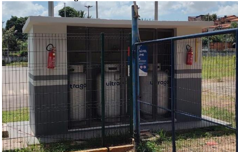
Figura 30 – Central de Gás
