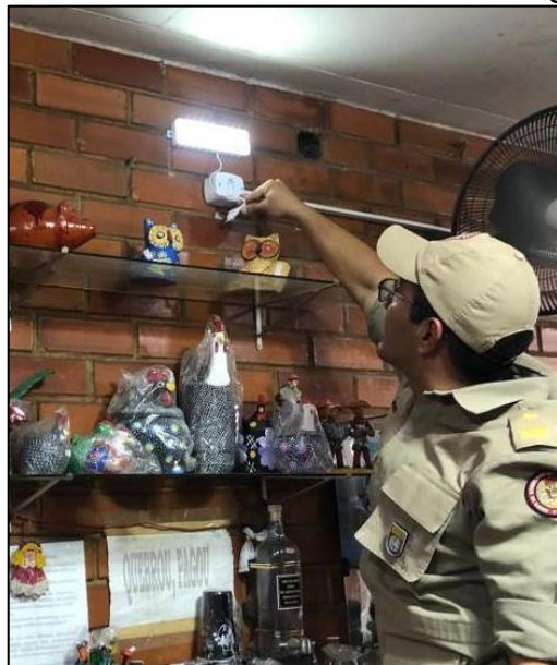
Figura 16 – Teste da Luminária de Emergência
