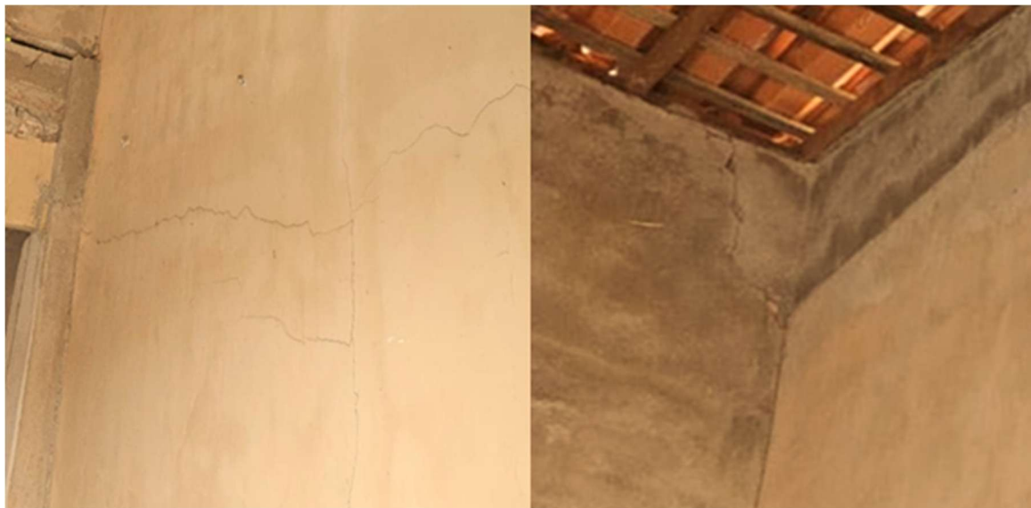
Figura 5: Rachaduras identificadas em residência dentro dos campos
