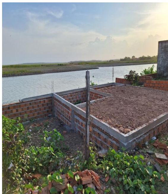
Figura 10 - Construção de residência nos perímetros dos campos alagados.
