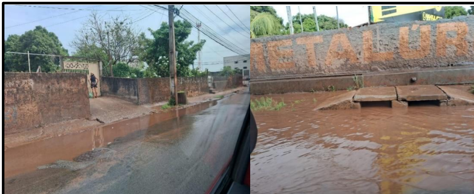
Foto 1 - Pontos de alagamento na MA - 201
