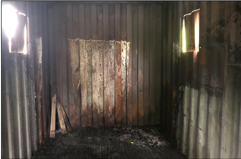
Figura 4 - Área interna do contêiner
