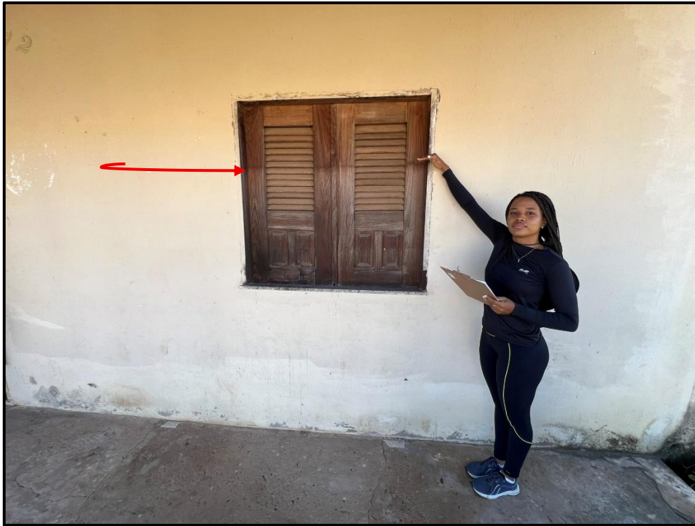
Figura 23 - Marcas das cheias nas fachadas das residências
