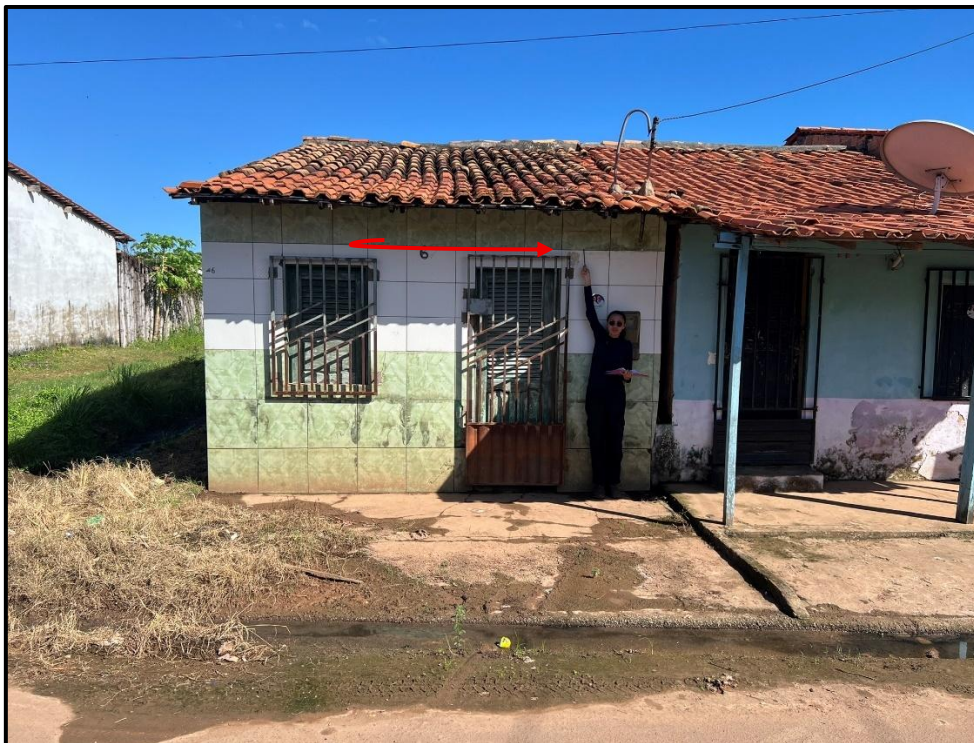
Figura 24 - Marcas das inundações em fachada de residência
