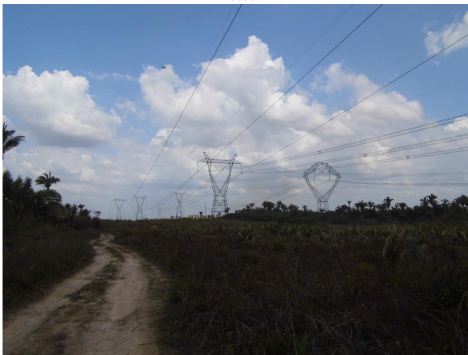
Figura 12 - Linhões de energia da Eletronorte, que atravessam o território de Santa Rosa dos Pretos.
