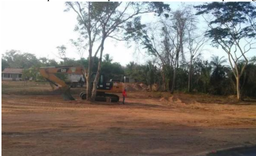
Figura 10 - Máquina do DNIT após fazer desmatamento e entupir um Igarapé.
