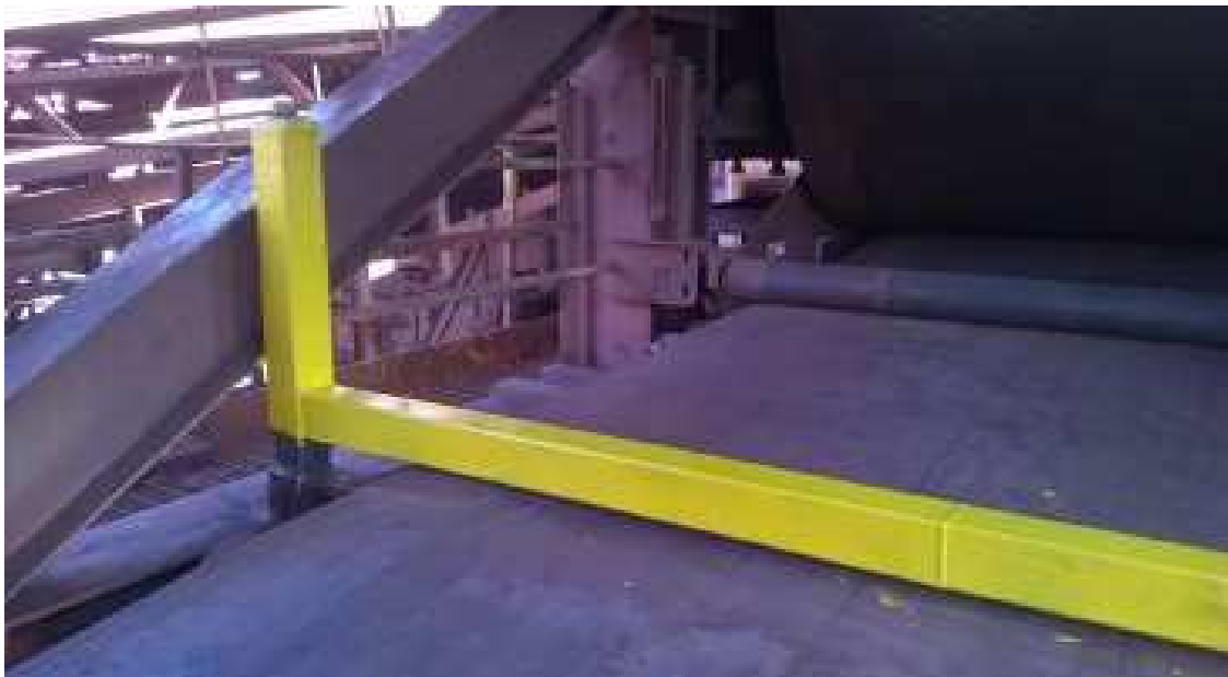
Figura 25 - Dispositivo instalado no TR 313K-60.
