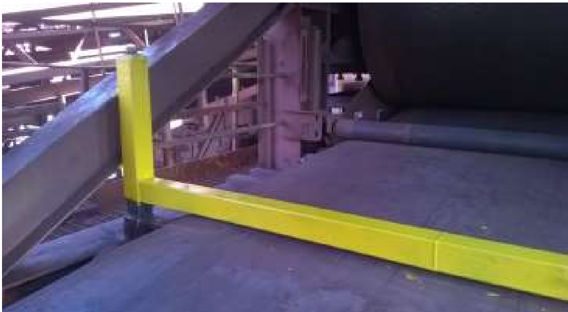
Figura 25 - Dispositivo instalado no TR 313K-60.
