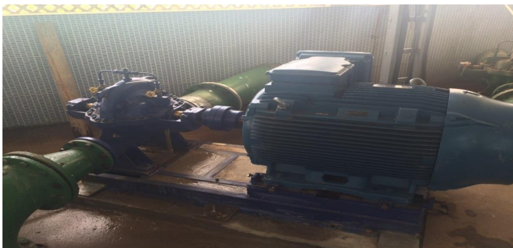
Figura 30. Motor de Bomba Centrífuga
