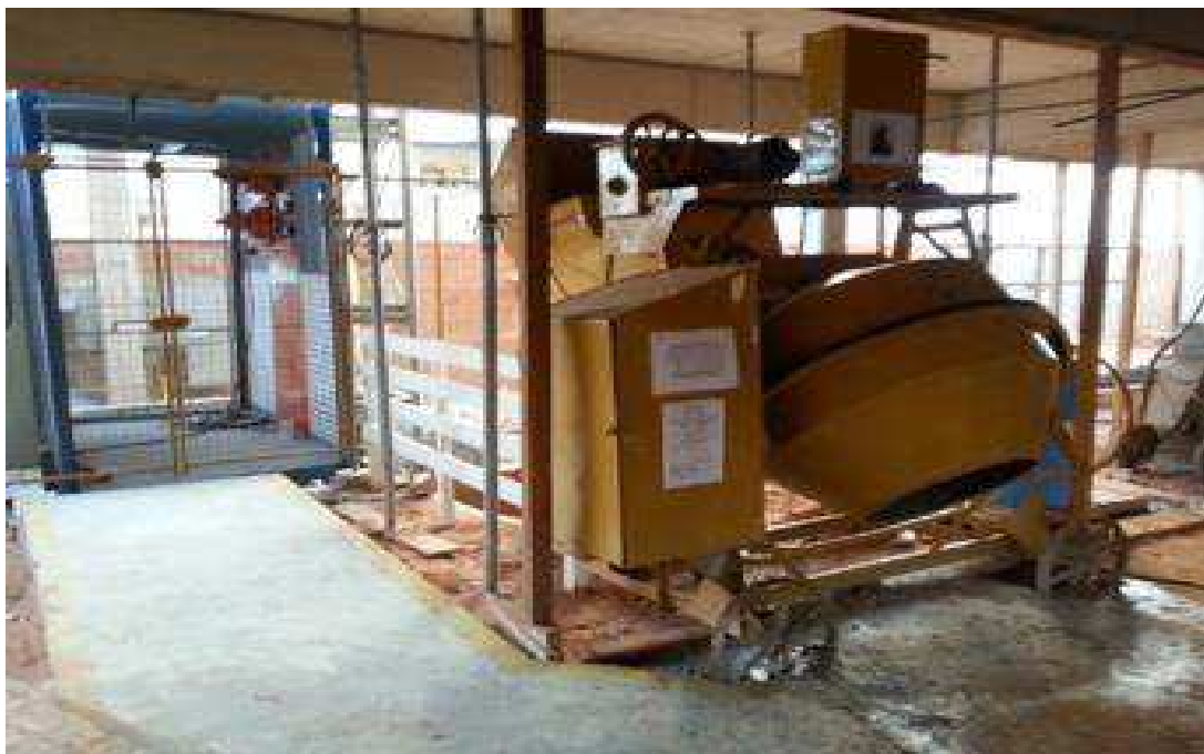
Figura 8 Mínima distancia entre a betoneira e o guincho de carga
